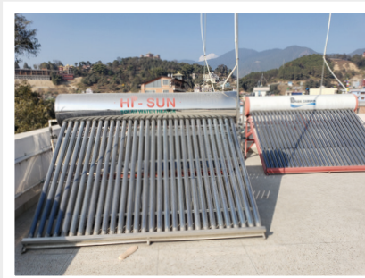
▲ Neue Solarpaneele für Warmwasser.
